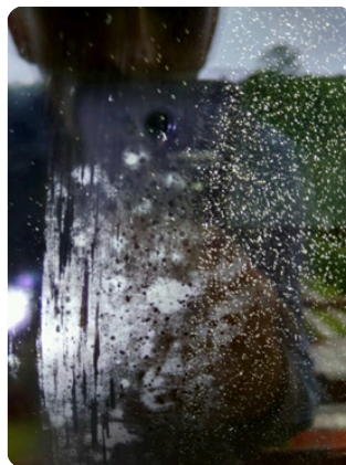
Przykład korozji na szkłe w formie kropek z tynku
